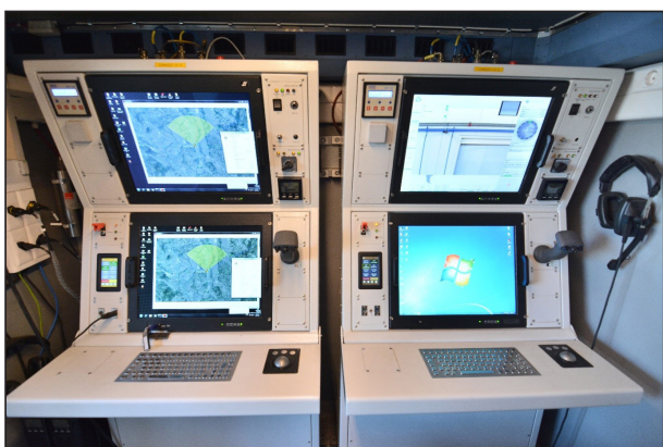
Deux consoles de poste de contrôle dans la cabine pouvant être placée sur une remorque ou un boîtier monté sur un véhicule
